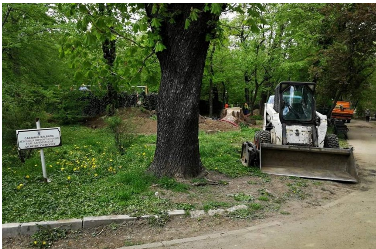
Fig. A1.3 - Exemplu referitor tasarea solului prin depozitarea echipamentelor de lucru pe rădăcinile arborilor (în această imagine, realizată în 2018, este surprins unul dintre arborii protejați din București, care între timp a și dispărut din cadrul amenajării)
