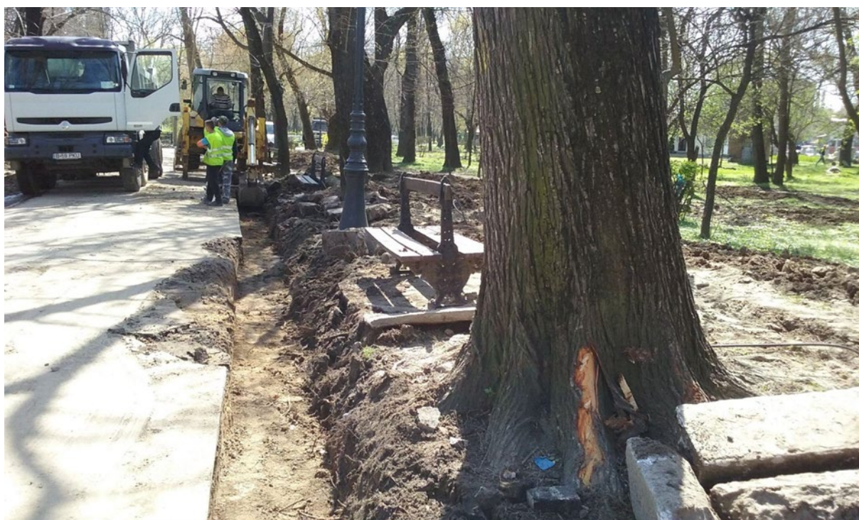
Fig. A1.1 - Exemplu referitor la rănirea trunchiurilor arborilor existenți pe parcursul realizării unor intervenții de amenajare în lipsa instalării unor sisteme de protecție
