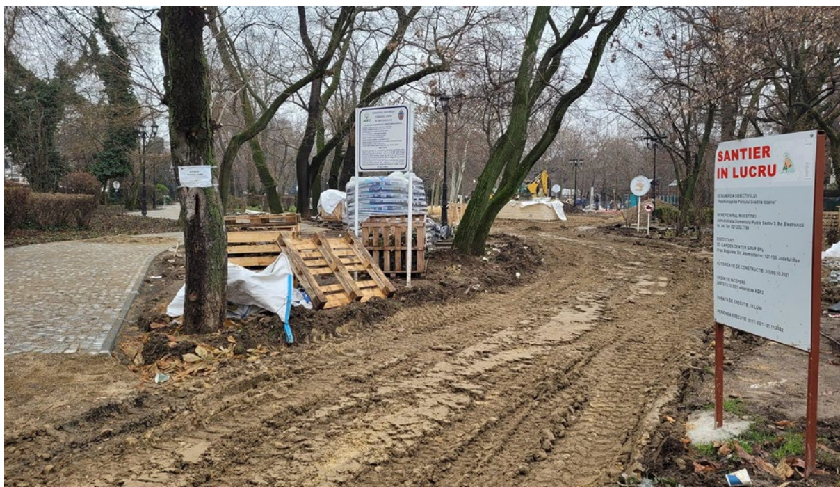
Fig. A1.2 - Exemplu referitor tasarea solului prin depozitarea materialelor de construire pe zona unde se află rădăcinile arborilor
